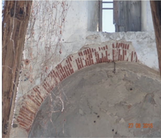
Şekil 15. Dökülen Sıva ve Boya Tabakaları Sonucunda Açığa Çıkan Duvar Örgüsü
